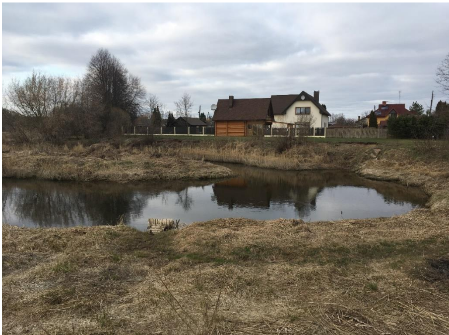
20.attēls Svētes upes krasta erozija piketā 220/40
