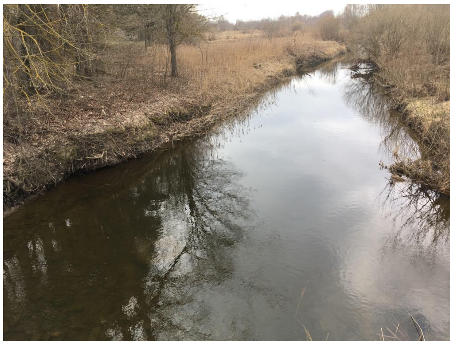
17.attēls Svētes upes krasta erozija pietā 137/00
