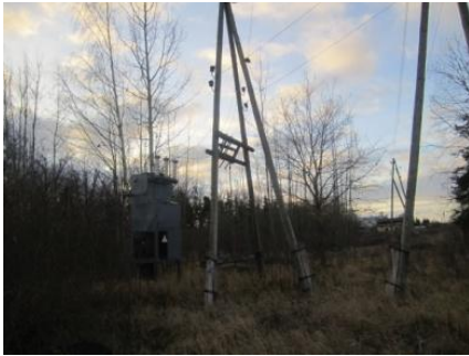
12.attēls 20 kV elektrolīnijas transformatora būve Lietuvas ielā 2.
