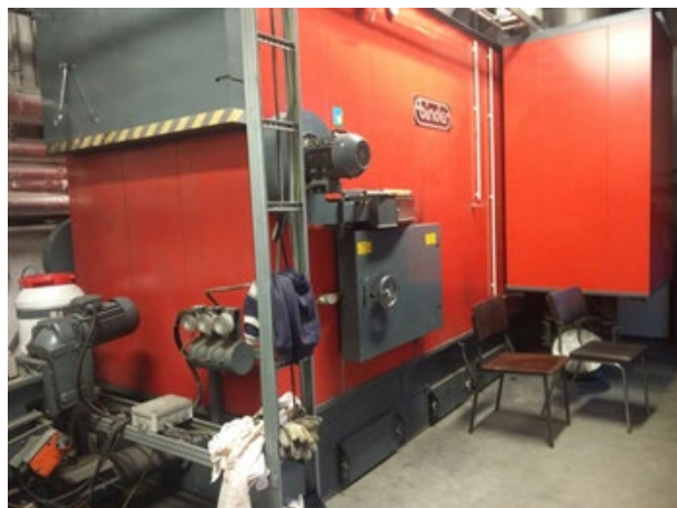
2.15. ATTĒLS: Apkures katls Staļģenes vdsuskolā
