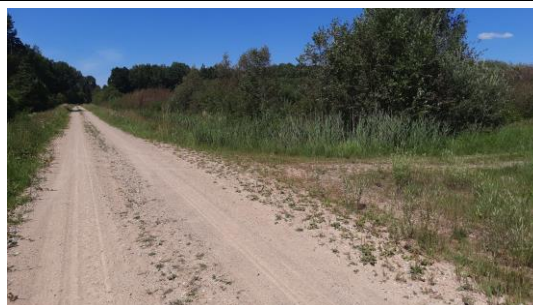
Ceļa servitūta teritorija un uz tā esošā akciju sabiedrība "Latvijas valsts meži" piederošā būve: Ūziņu kapi-10.kv
