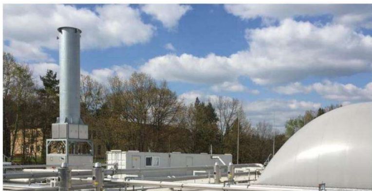
2.9. attēls. Fermentatora jumts ar tehniskajiem konteineriem, gāzes uzkrāšanas tvertni un uzliesmotāju
