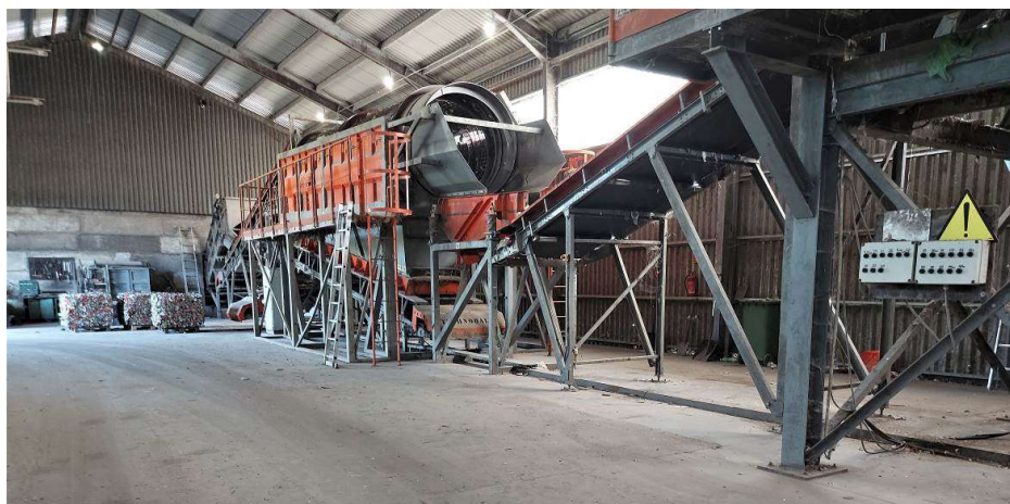
3.4. attēls. Nešķirotu sadzīves atkritumu šķirošanas līnija. Centrālajā daļā – trumuļtipa siets bioloģiski noārdāmās frakcijas atdalīšanai
